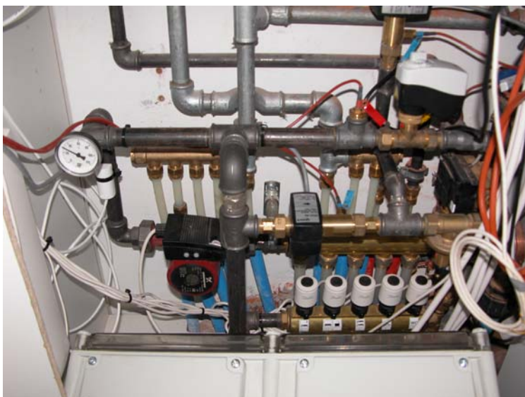
Figur 9. Billede af varmeinstallationen, der viser blandesløjfe, blandeventil (øverst til højre), pumpe og energimålerens flowmålerdel og temperaturfølere.
